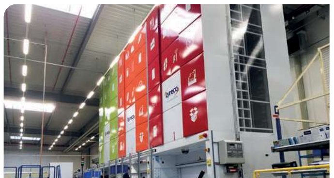
Mit Brandschutzsystemen ausgestattete Maschinen
